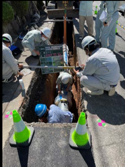
②管位置検査
